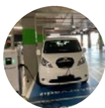
Postos de Carregamento Automóveis Elétricos
