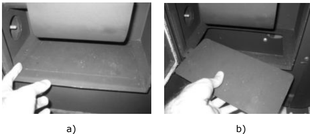
Figura 117 - Limpieza del interior de la estufa
