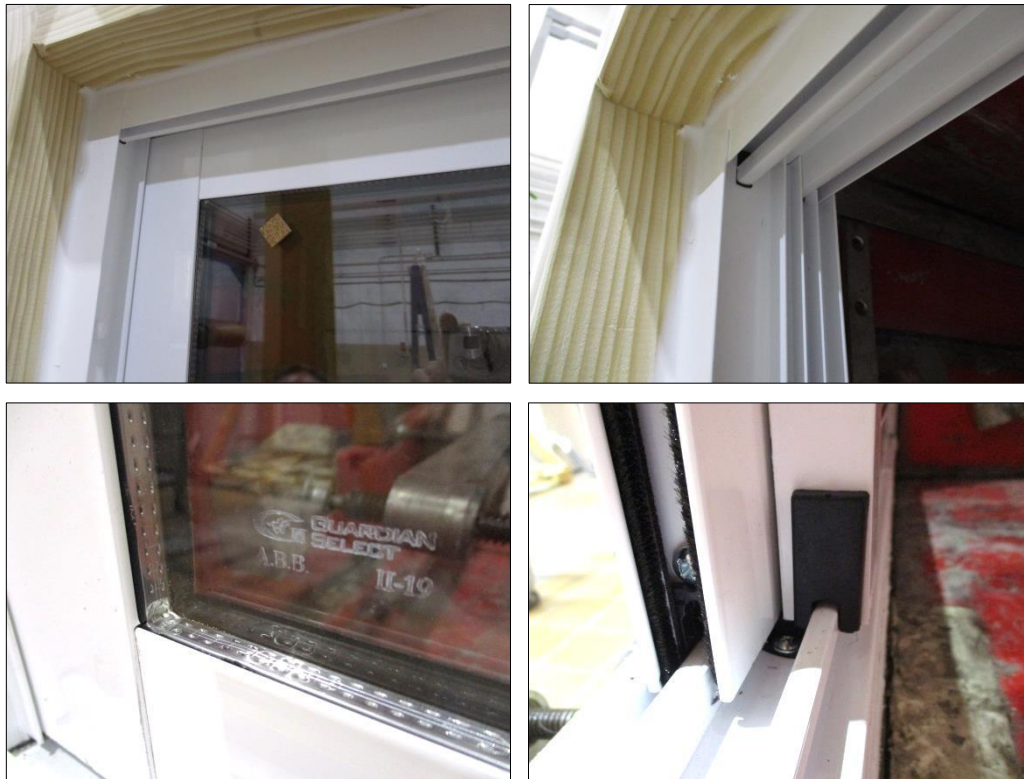
Foto N°.3. Detalle de perfiles y juntas
