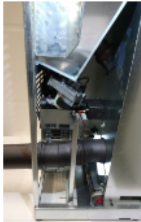
Fig. 62 - Sortie de fumées postérieure Sharp
